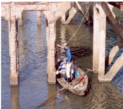
(a) Các trụ cầu bị ăn mòn cốt thép ở Phan Thiết cách biển 1 km
